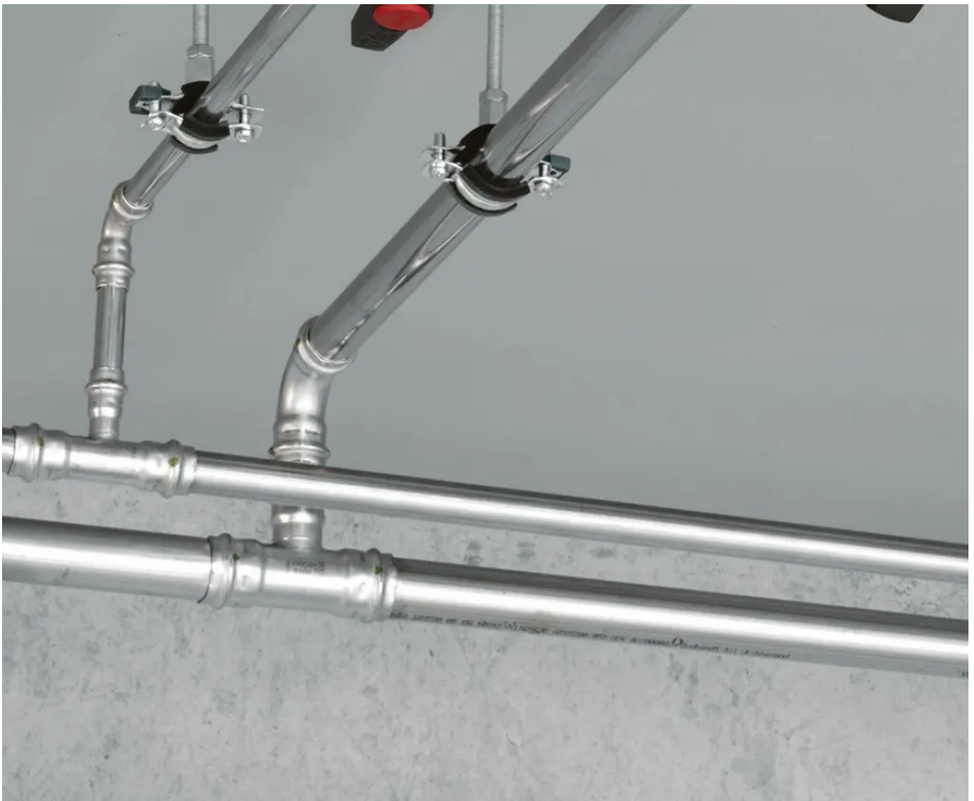
Bild 4: Die Sanierung der Trinkwasser-Installation für den normgerechten thermischen Abgleich wurde mit „AquaVip-Zirkulationsregulierventilen elektronisch“ vorgenommen.
